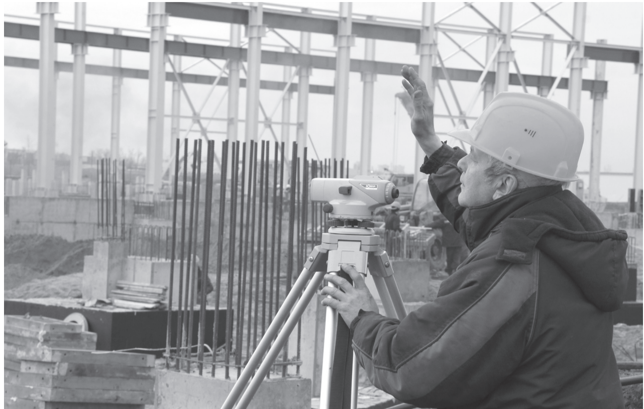
Промзона «Заволжье». Строительство станкостроительного завода немецко-японского концерна DMG Mori, начавшего работу 29.09.2015. Завод стал первым примером трансфера технологий в современной истории РФ. Эксперты уверены, что индустриальный парк «Октябрьский» повторит успех «старшего» брата.
